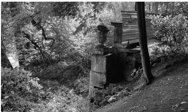
Архитектурный элемент Большого каскада в Павловском парке. До реставрации
